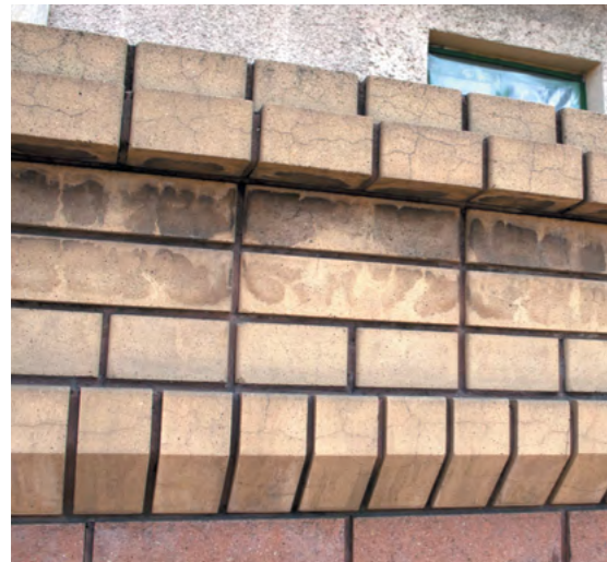
Загрязнения на кирпичной кладке
