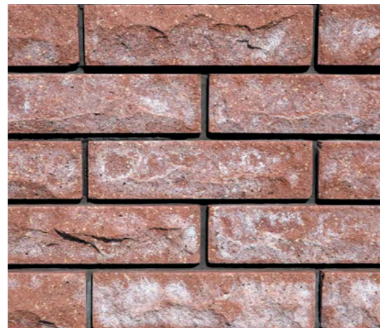
Высолы на кирпичной кладке
